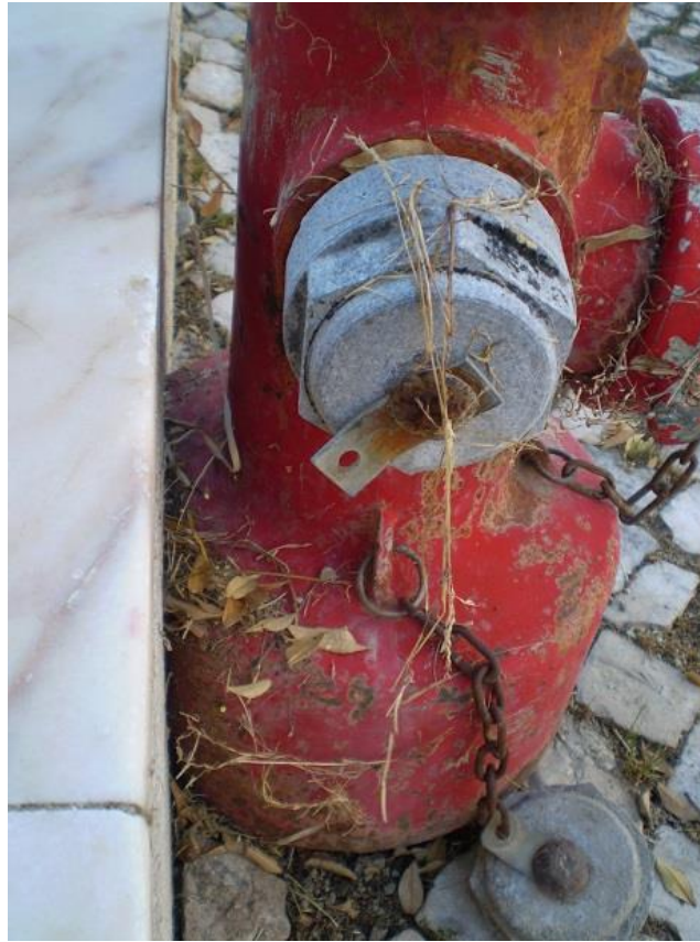
Boca de SI junto a habitação e espaço verde na Rua prof. Moisés Amzalak, nº 11
